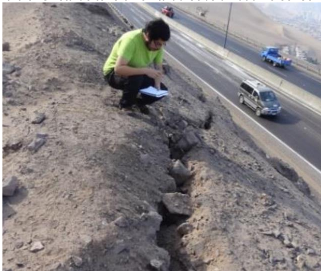
Figura 6-5: Grieta de tensión en talud sobre unidad no consolidada.
